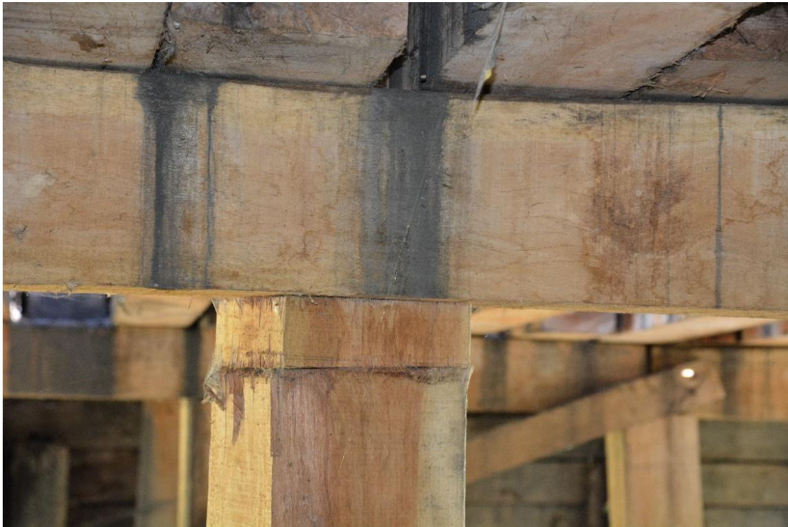
Calço entre o pilar e a viga travessa
