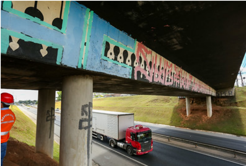
Má conservação da pintura
