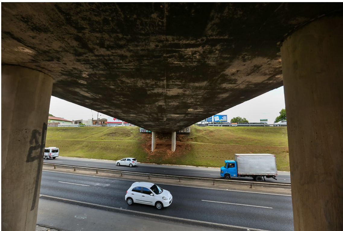
Presença de fungos que deterioram o concreto.
