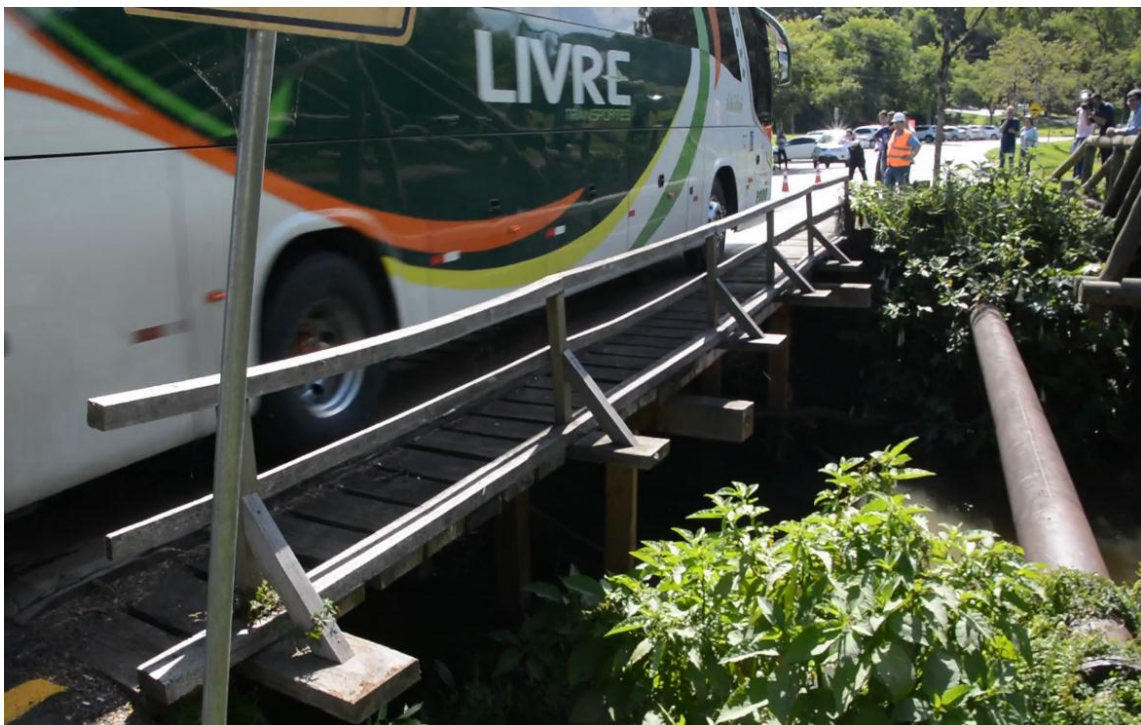
Trânsito de veículos pesados sobre a OAE
